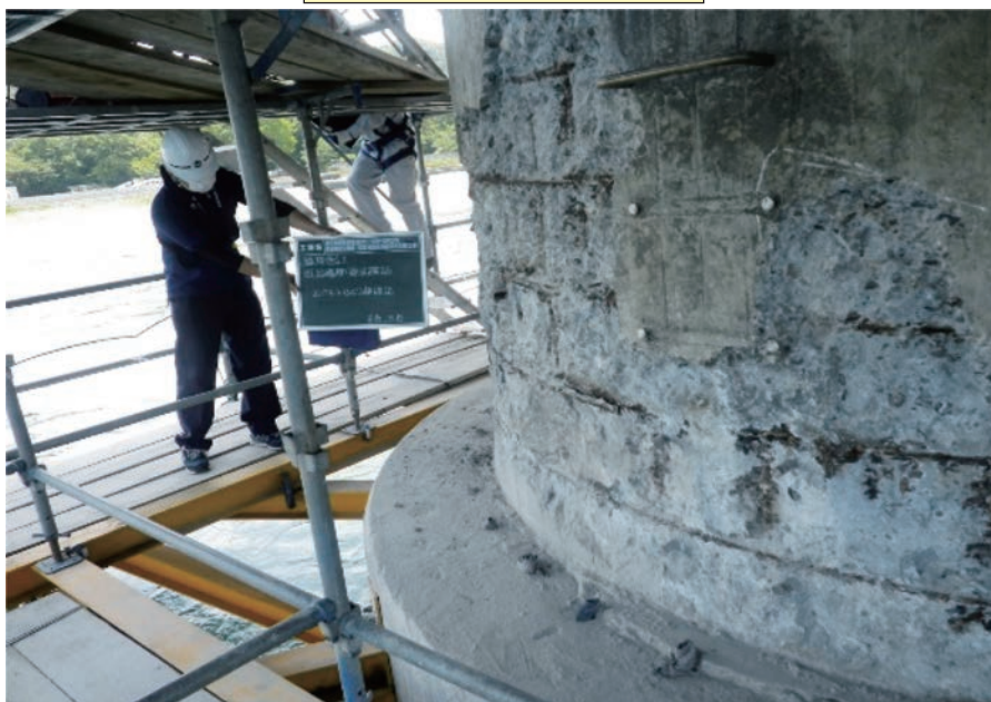
劣化した鉄筋による コンクリートの剥離状況
