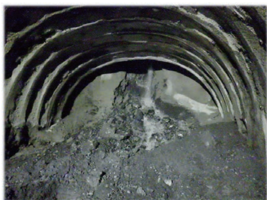
写真2 横島トンネル突発湧水
