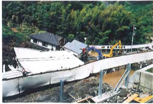
写真-2 崩土により自動車修理工場や家屋を共用中の国道まで押し出す。四車線化の工事安全防護柵が崩土を止める。
